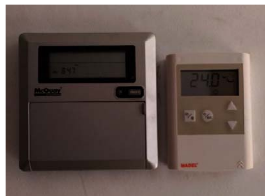
Imagen 79. Controlador de compuertas de aire
