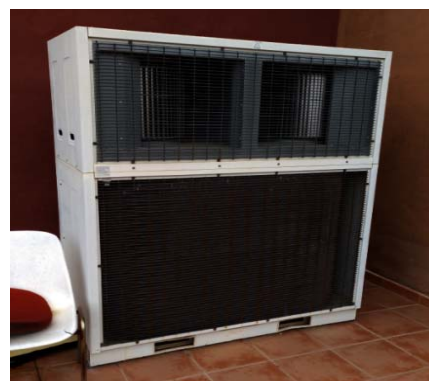
Imagen 72. Unidad exterior común
