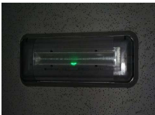
Imagen 78. Alumbrado de emergencia con tecnología LED
