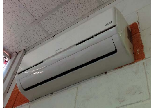
Imagen 49. Unidad interior tipo Split
