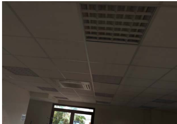
Imagen 69. Luminarias instaladas en las salas
