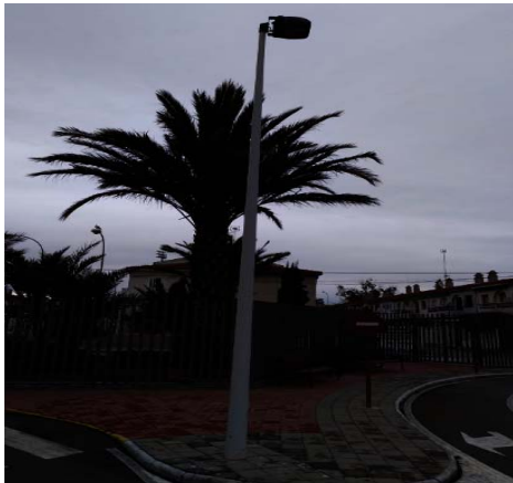
Imagen 54. Luminarias viales exteriores
