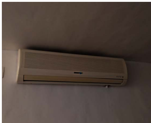
Imagen 57. Unidad interior tipo Split
