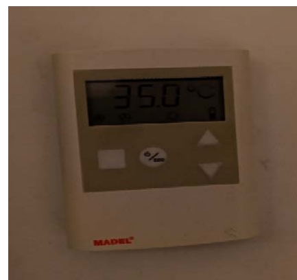
Imagen 64. Controlador compuertas de aire
